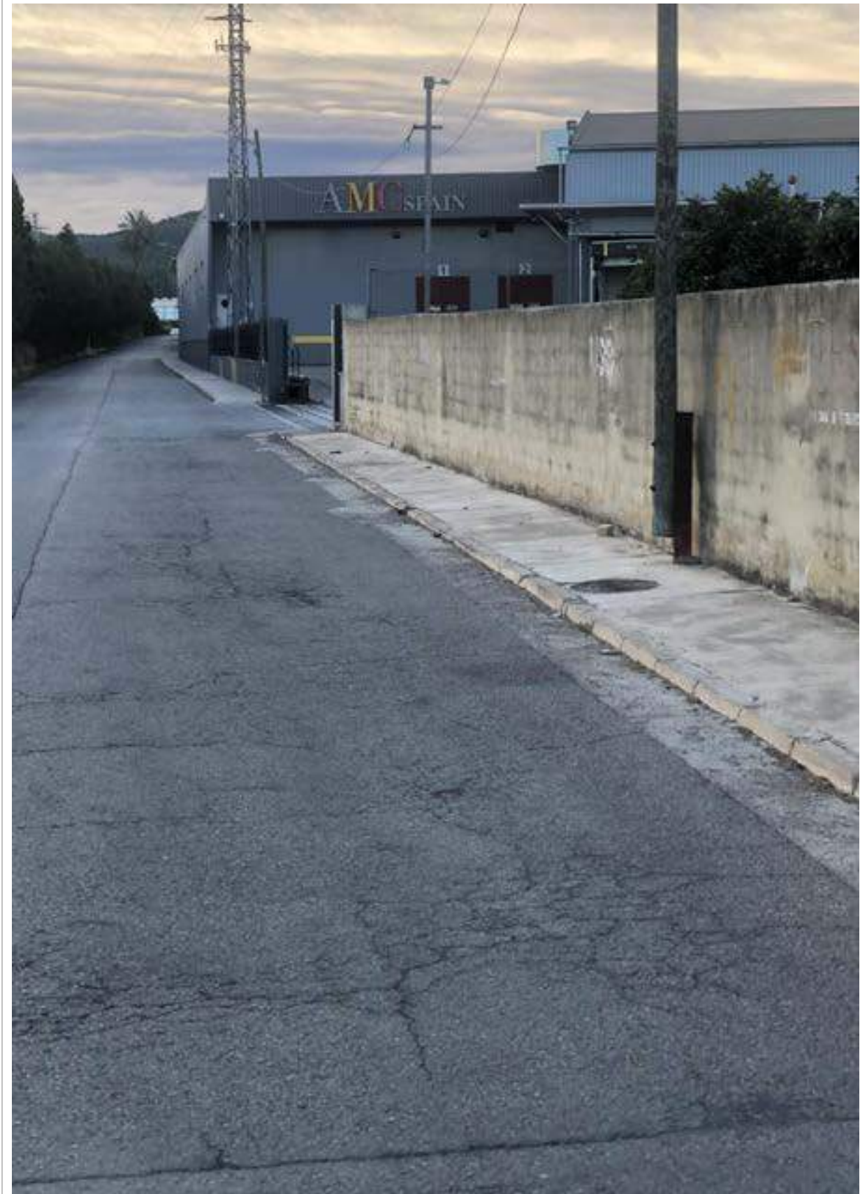
Vial Este. Detalle del estado del firme
