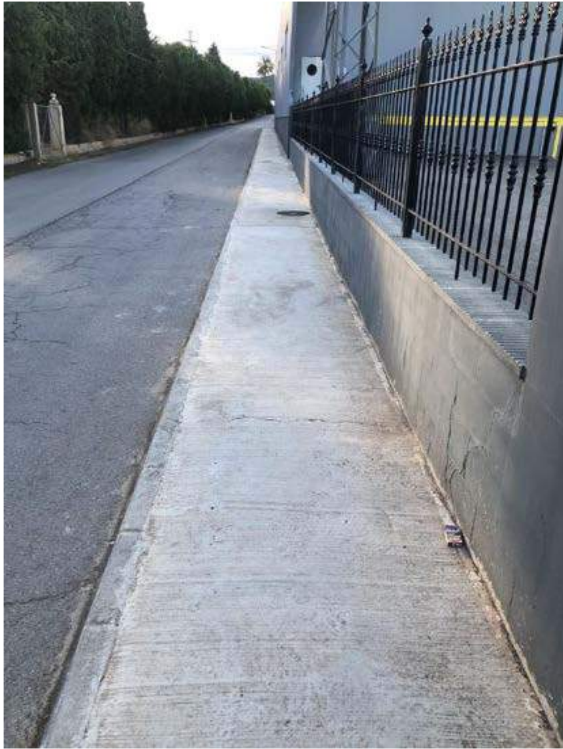
Vial Este. Estado acera existente
