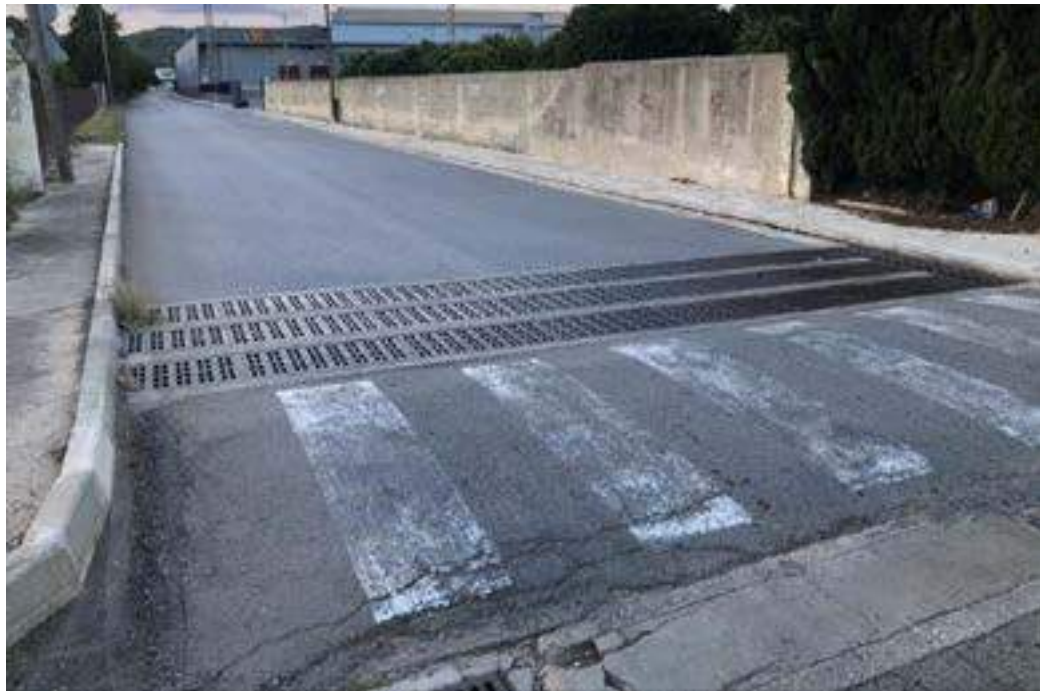
Punto de conexión del sistema de drenaje proyectado con el existente. Vial Este
